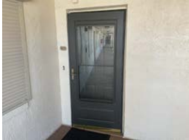
Unit entry door
