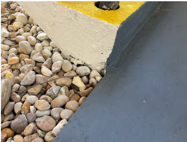
Concrete edge spall
