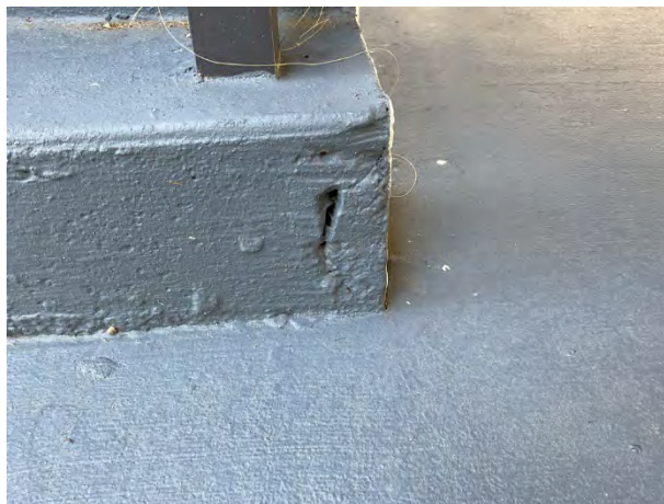
Concrete edge spall
