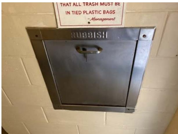
Trash chute door
